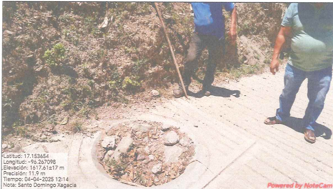
Imagen 16.- Pozo de visita completamente azolvado.
