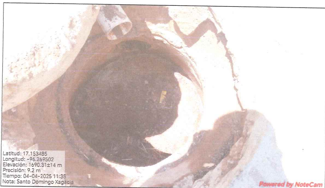
Imagen 17.- Pozo de vista azolvado.
