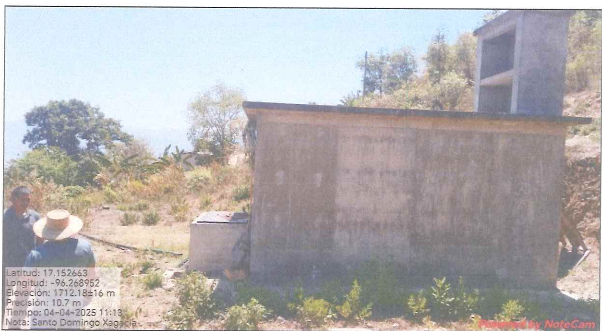
Imagen 12.- Tanque 02 con presencia de fisuras y sin concluir desde su construcción.
