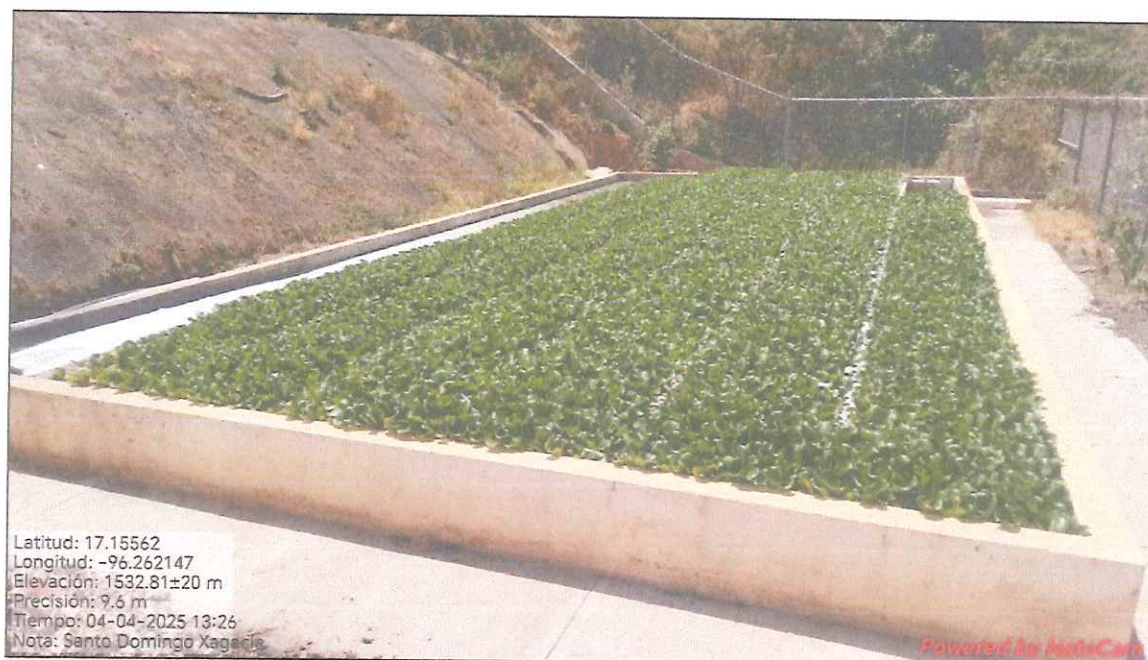
Imagen 22.- Situación actual del humedal, falta un medio filtrante al fondo y tanque de contacto de cloro al final del humedal.
