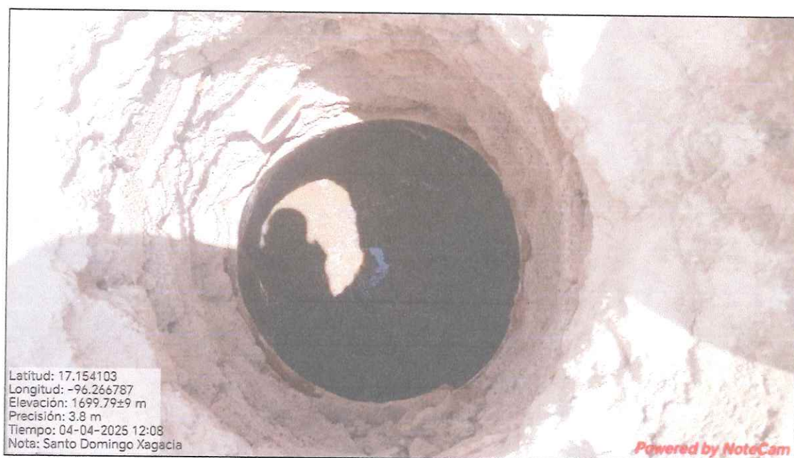
Imagen 18.- Pozo de visita colapsado y con deficiencias desde su proceso constructivo.
