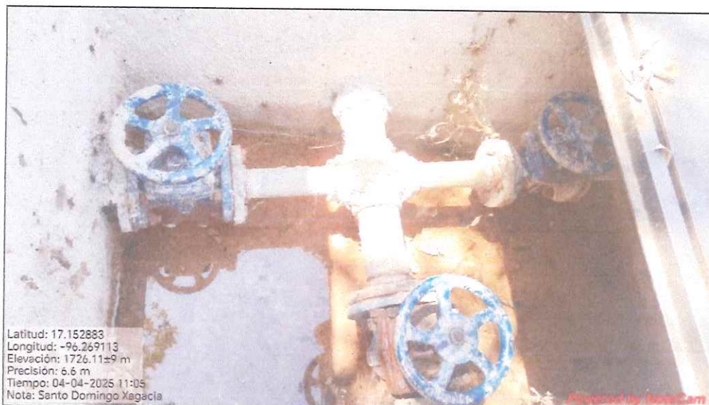
Imagen 13.- Válvulas con presencia de fugas en la red de distribución.
