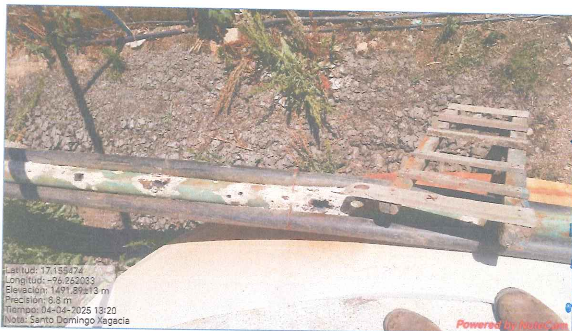
Imagen 21.- Situación actual de las tuberías de la planta de tratamiento, presentan fugas.
