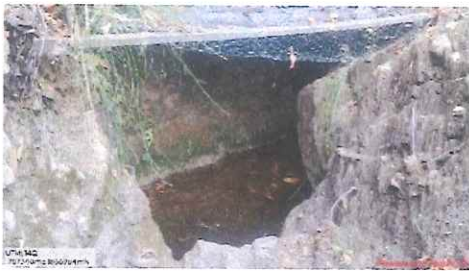
Fot. 1 Estado actual de la captación
