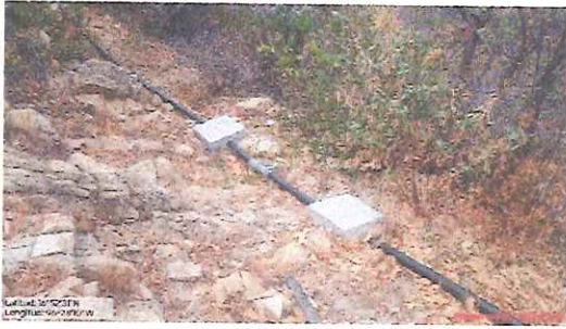
Fot. 13 Estado actual de la línea de conducción
