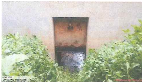
Fot. 9 Compuerta deteriorada por oxidacion
