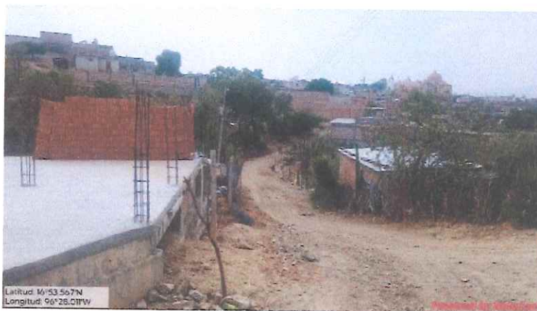
Fot. 22 Mostrando el estado actual en que se encuentra la calle.
