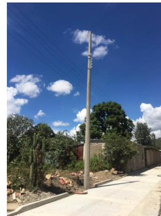
Imagen 32. Red de distribución de energía eléctrica en Santo Tomás Jalieza Fuente: Propia autoría
