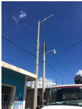
Imagen 30. Red de distribución de energía eléctrica en Santo Tomás Jalieza Fuente: Propia autoría
