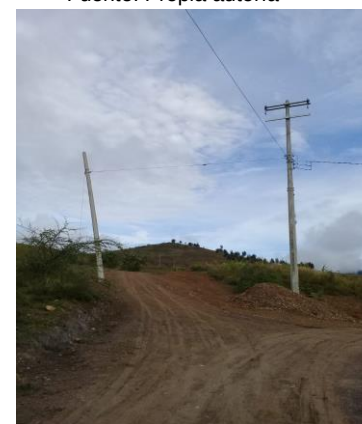
Imagen 35. Red de distribución de energía eléctrica en Santo Tomás Jalieza Fuente: Propia autoría
