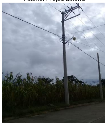
Imagen 34. Red de distribución de energía eléctrica en Santo Tomás Jalieza Fuente: Propia autoría
