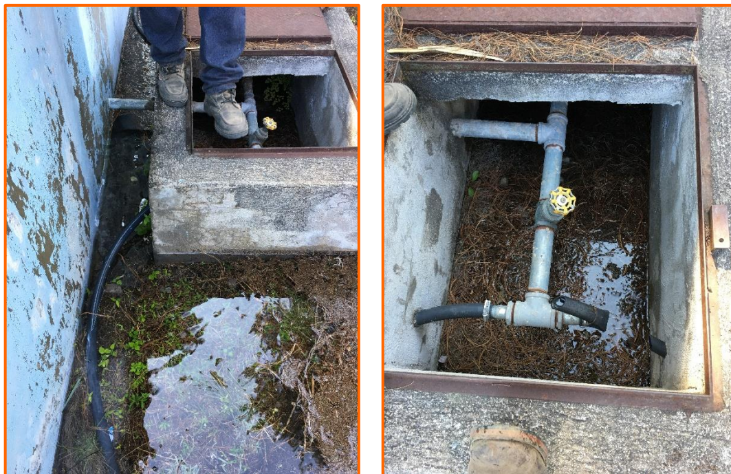
Figura 26. Condiciones de tubería a reparar en Llano Grande
